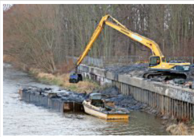
Im Elsterbecken wurde gestern Aushub abtransportiert. Besondere Vorkehrungen seien nicht notwendig, hieß es dort. Hochwasserschützer sehen das anders. Foto: André Kempner
